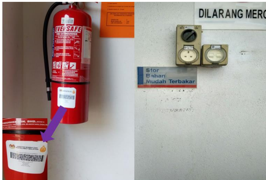
Alat pemadam api mempunyai sijil pengesahan dari pihak bomba, berparkir dan dipasang pada dinding
